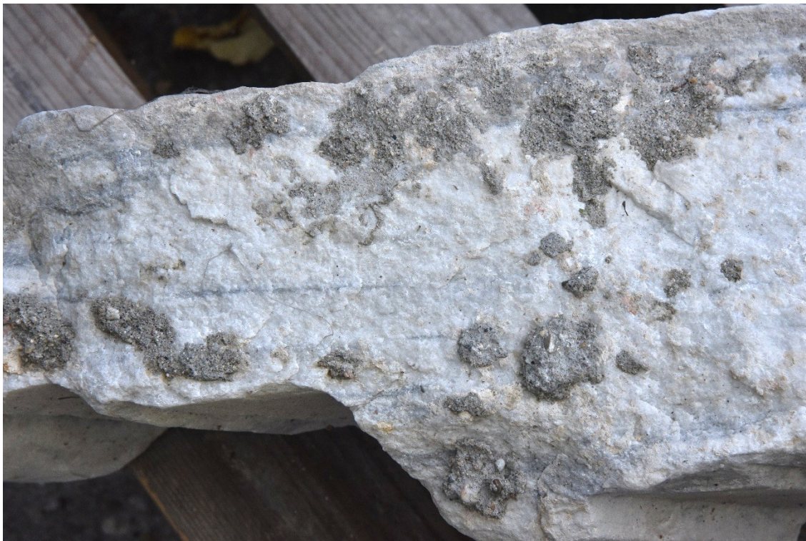
Fot. 12 Na powierzchni przetamów natrafiono na wtórne zabrudzenia z zapraw mineralnych
