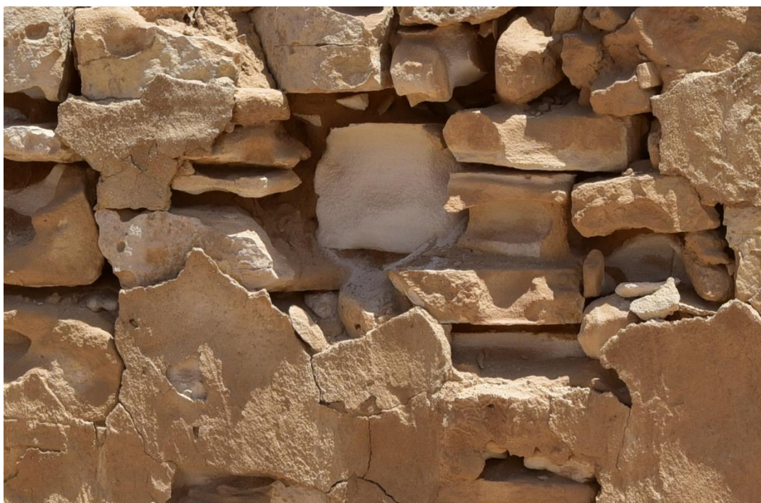
Fot. 53 Fragment uszkodzeń muru w domu H1, typowych dla ścian z kamienia łamanego. Przestrzenie pomiędzy licowaniem wypełnione gruzem i piaskiem z gliną
