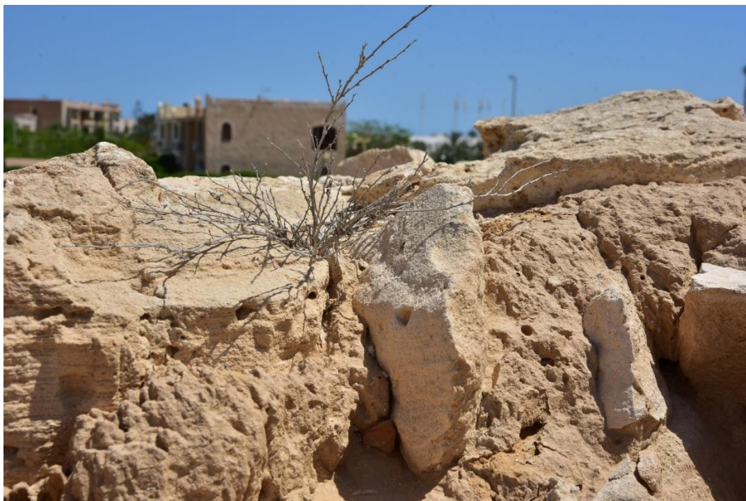
Fot. 52 Roślinność wrastająca w zaprawę, powodująca stopniowe rozsadzanie murów
