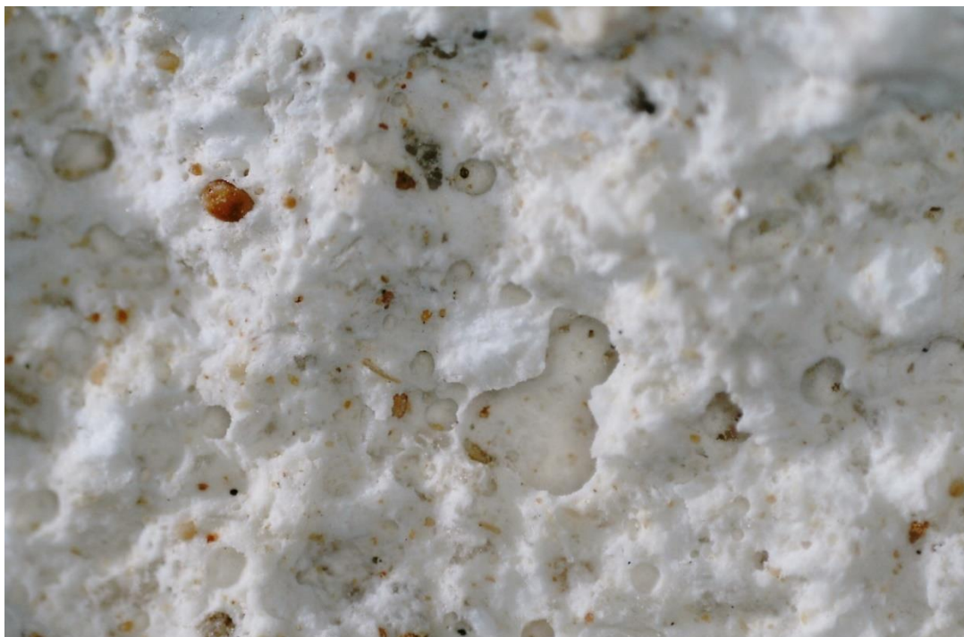
Fot. 19 Fragment tynku ze ściany wschodniej klatki schodowej domu H1. P1 obraz w powiększeniu x 20
