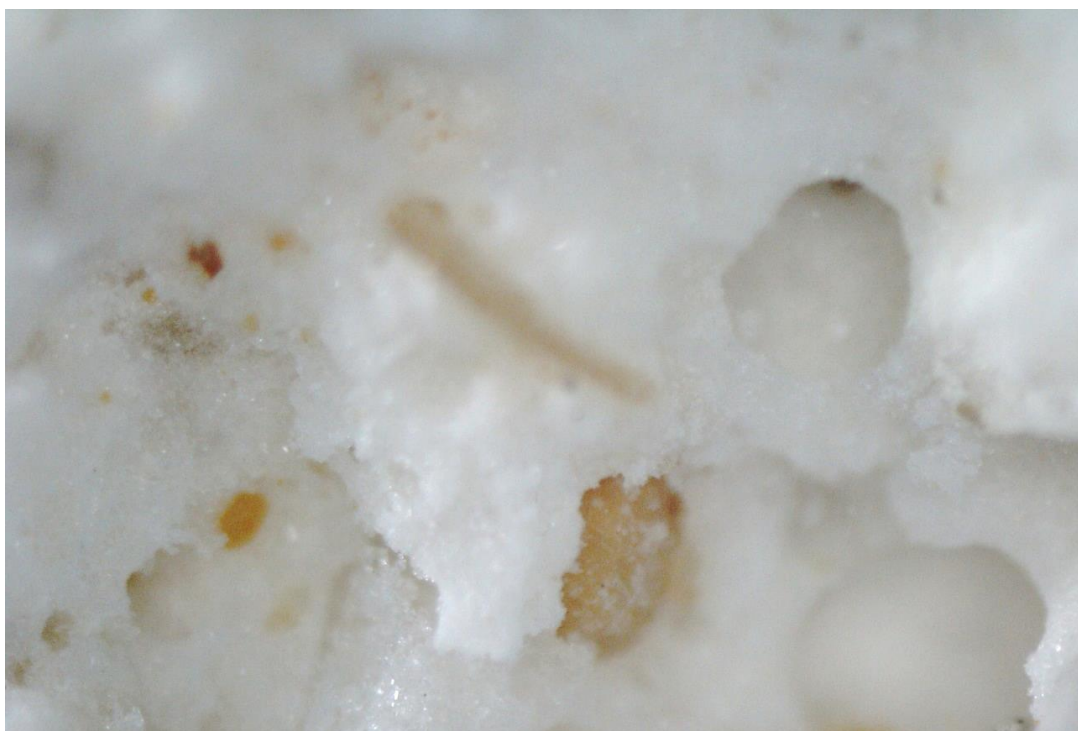
Fot. 20 Fragment tynku ze ściany wschodniej klatki schodowej domu H1. P1 obraz w powiększeniu x 200
