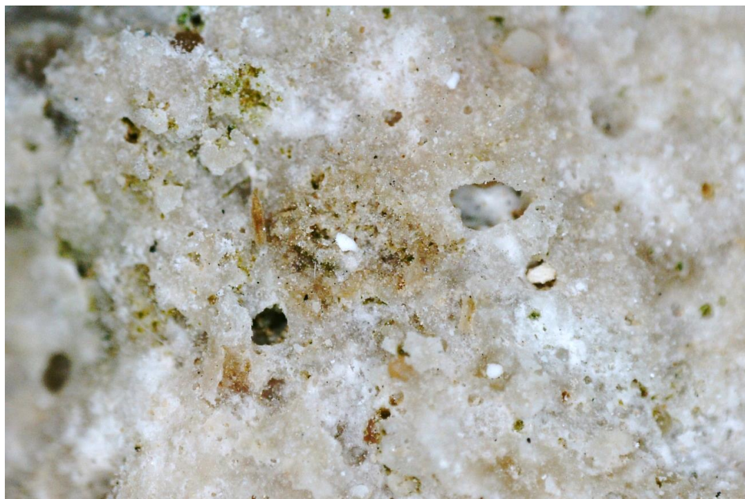
Fot. 26 Fragment zaprawy ze spoiny bloków za ściany zachodniej klatki schodowej, dom H1. P4 Powiększenie x 20
